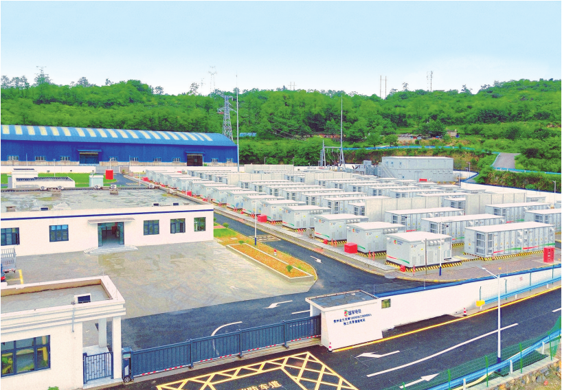
贵州金元关岭独立共享储能电站。
