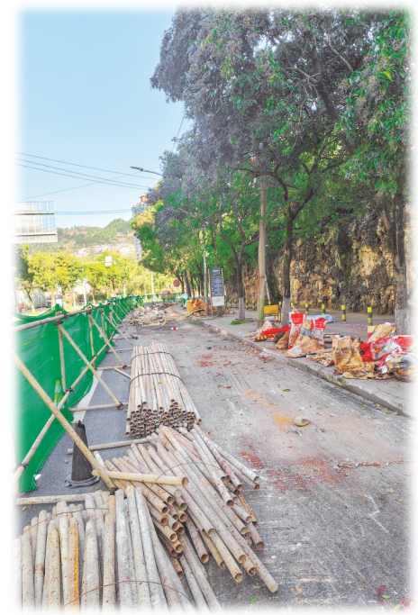
刚修好的道路又开挖。
