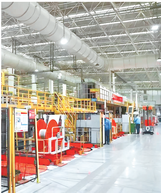
贵州轮胎股份有限公司智能生产车间。（省科技厅供图）
