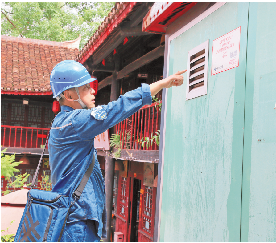
供电局工作人员检查博物馆专用箱变。
