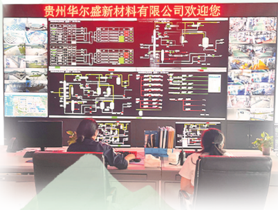
贵州华尔盛新材料有限公司中控室。 贵州日报天眼新闻记者 周强 摄
