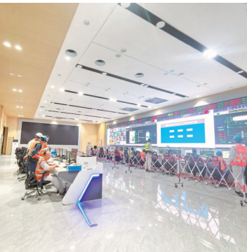
贵州大湾2×660MW低热值（CFB）煤电项目集控室。 贵州日报天眼新闻记者 顾冰洁 摄
