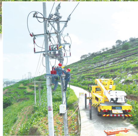
工作人员安装新型配电网一二次融合自动化开关。吴春艳 摄
