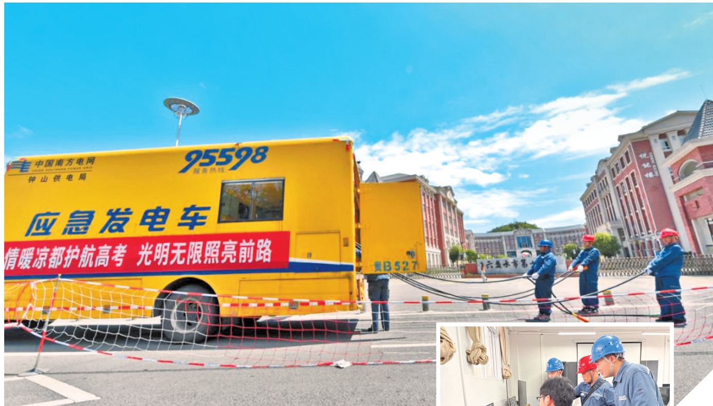
↑六盘水供电局工作人员在考点布置应急发电设备。 李泉 摄
