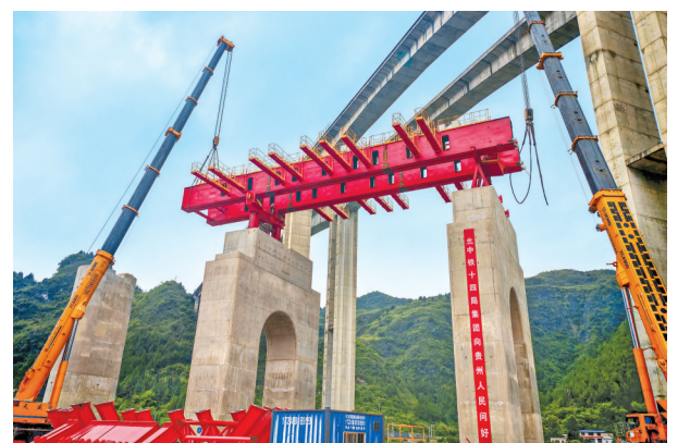
近日，在中铁十四局吉铁路跨渝怀铁路特大桥25号墩施工现场，重达120吨的移动模架主梁，在两台900吨吊车巨臂的精准协作下，稳稳攀上30米高的桥墩，顺利完成吊装作业。
