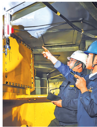
洪家渡发电厂维护人员对轴承油位检查。
