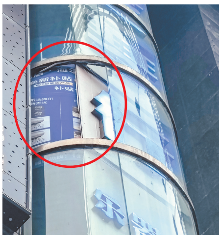
破损的玻璃依然没有修补好。
