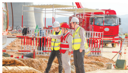
欧刚在工地查看进度（右一）。 贵州日报天眼新闻记者 汪瑞梁 摄
