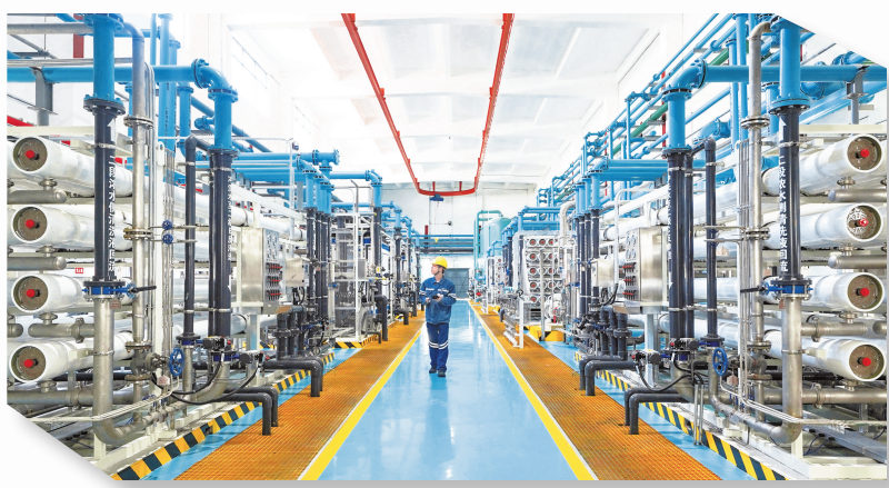
工作人员在贵州织金平远清洁能源有限责任公司“上大压小”煤电项目车间进行设备检查。高琦 摄 (影像贵州)
