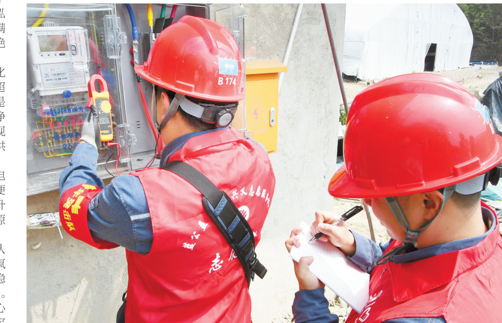
册亨供电局工作人员为养殖基地检查用电设备。李诗怡 摄
