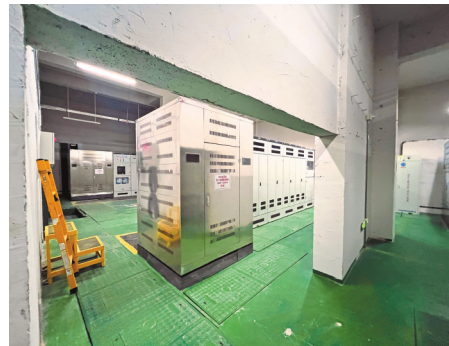
小区负一楼配电房设备已更新。
