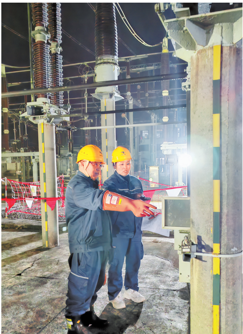
都匀供电局变电运行人员开展开关柜更换后的投运操作。
