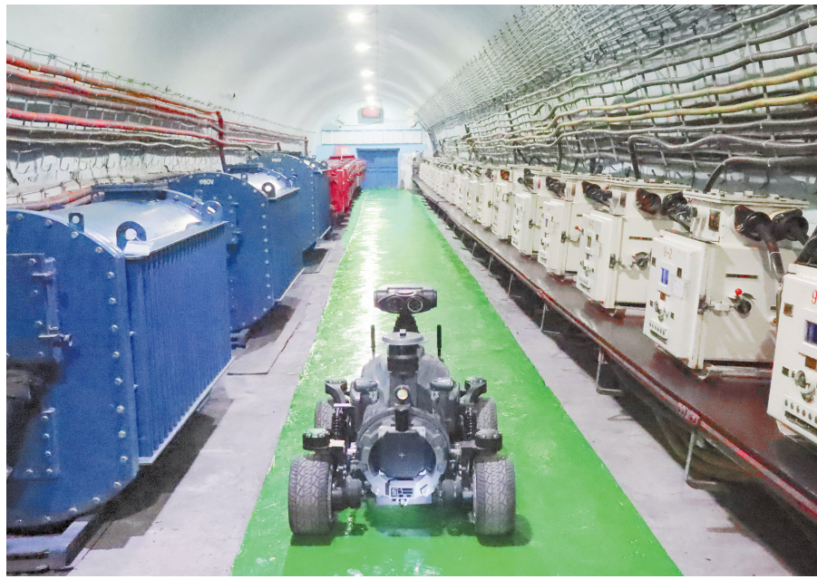
新田煤矿中央变电所巡检机器人。 通讯员 胡明军 摄
