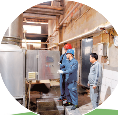
南方电网贵州电网公司工作人员对“电眼箱”的电锅炉设备进行用电检查。 陈举 摄
