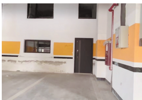
贵阳市中南林樾小区洋房区地下停车场，一面墙上“多出来”的5扇窗户及一扇防盗门。
