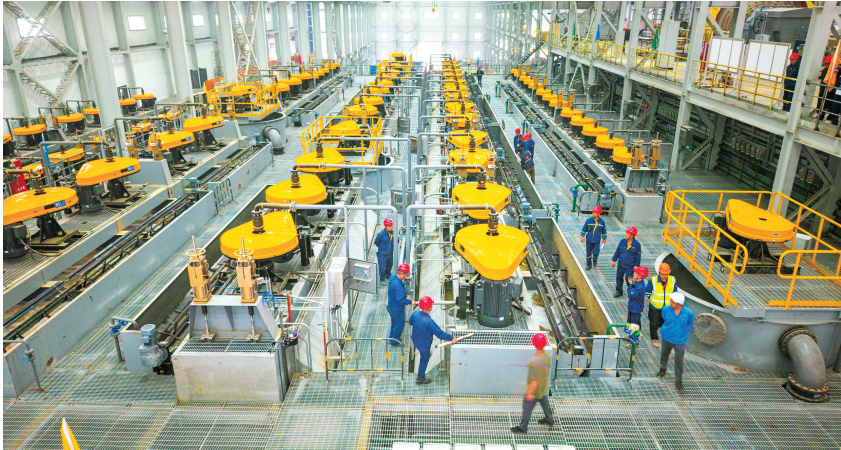
9月30日，赫章鼎盛鑫矿业拱坝铅锌矿选矿厂带式联动试车一次成功，这座探明铅锌金属资源量517.80万吨、位列全国铅锌矿床前十的超大型矿山，已具备试生产基本条件。图为技术人员正在察看设备运行情况。
