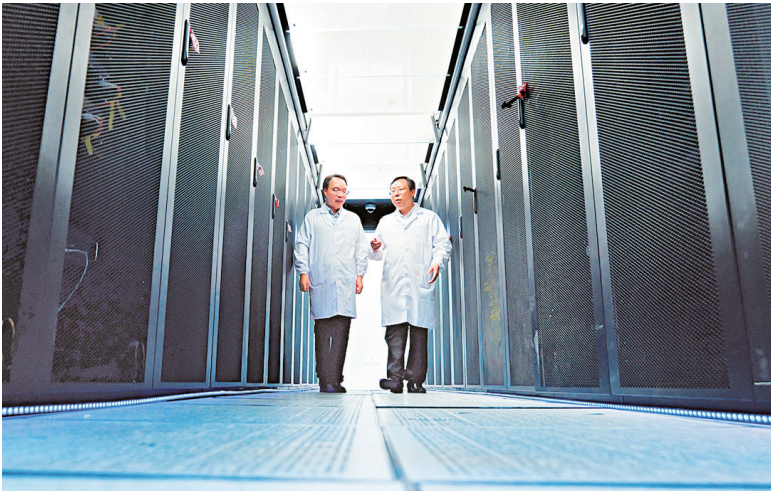
贵州理工学院李少波教授（右）与科研团队成员在网络中心数据机房进行日常巡检。
