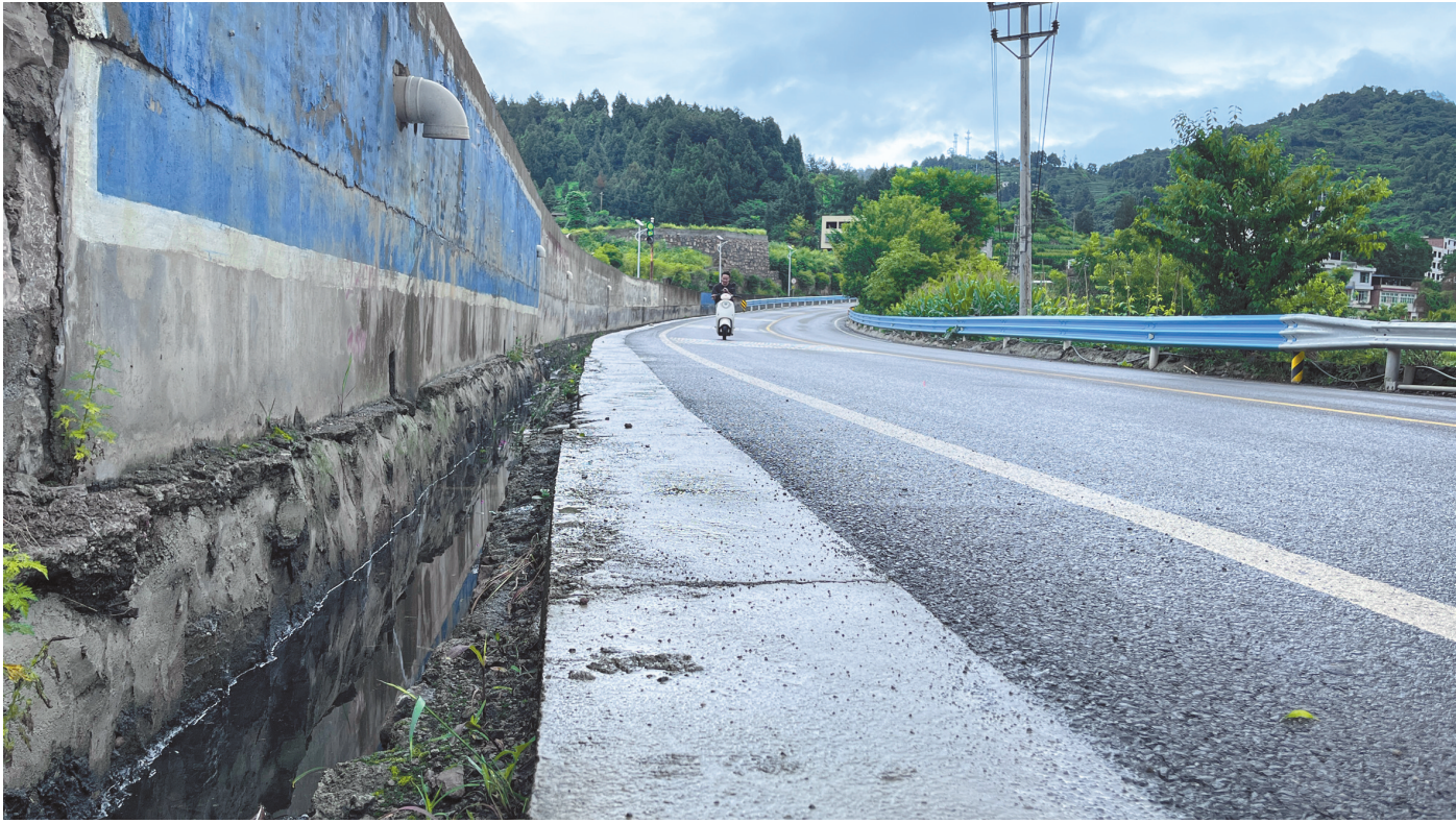
G212国道内侧边沟有积水。
