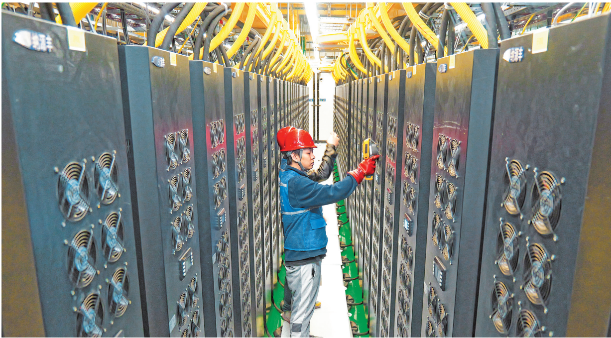
贵安超算中心工作人员巡检数据机房。
