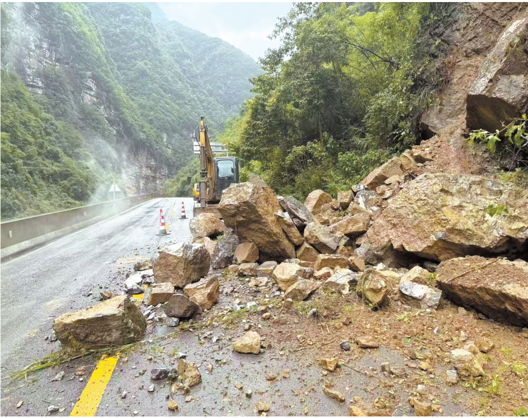
遵义市道真自治县G653线抢险路段。
