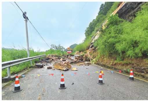
盘州市保田镇S318线K475+771处崩塌现场。
