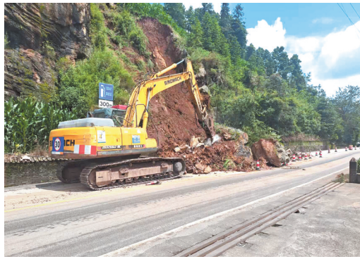
六枝特区岩脚镇S310线K336+990处（两岔路方向）暴雨冲刷引发山体坍塌。
