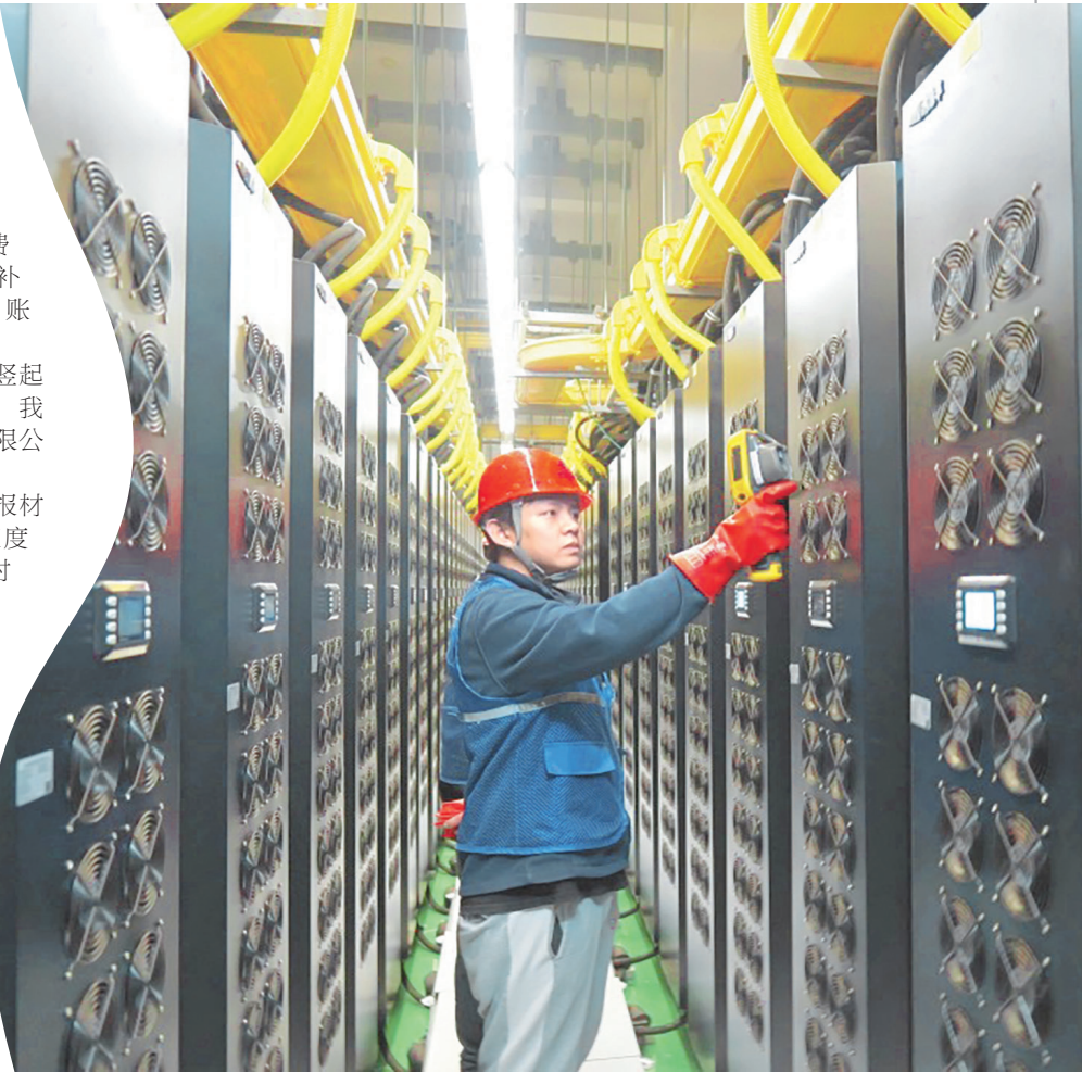
贵安超算中心工作人员开展日常巡检。贵州日报天眼新闻记者 杨涛 摄
