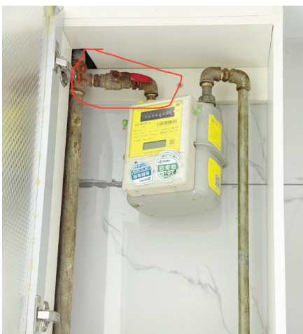
贵阳市乌当区交通巷11号楼居民家中生锈的燃气管道。
