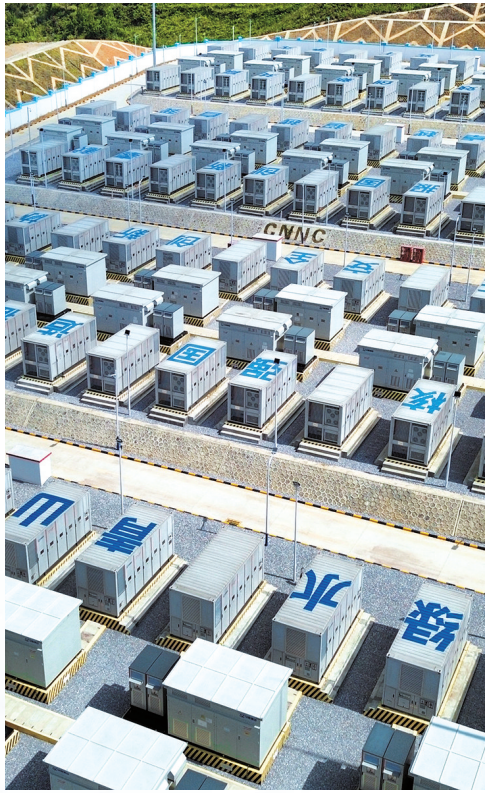
中核紫云储能电站。 杜延卿 摄
