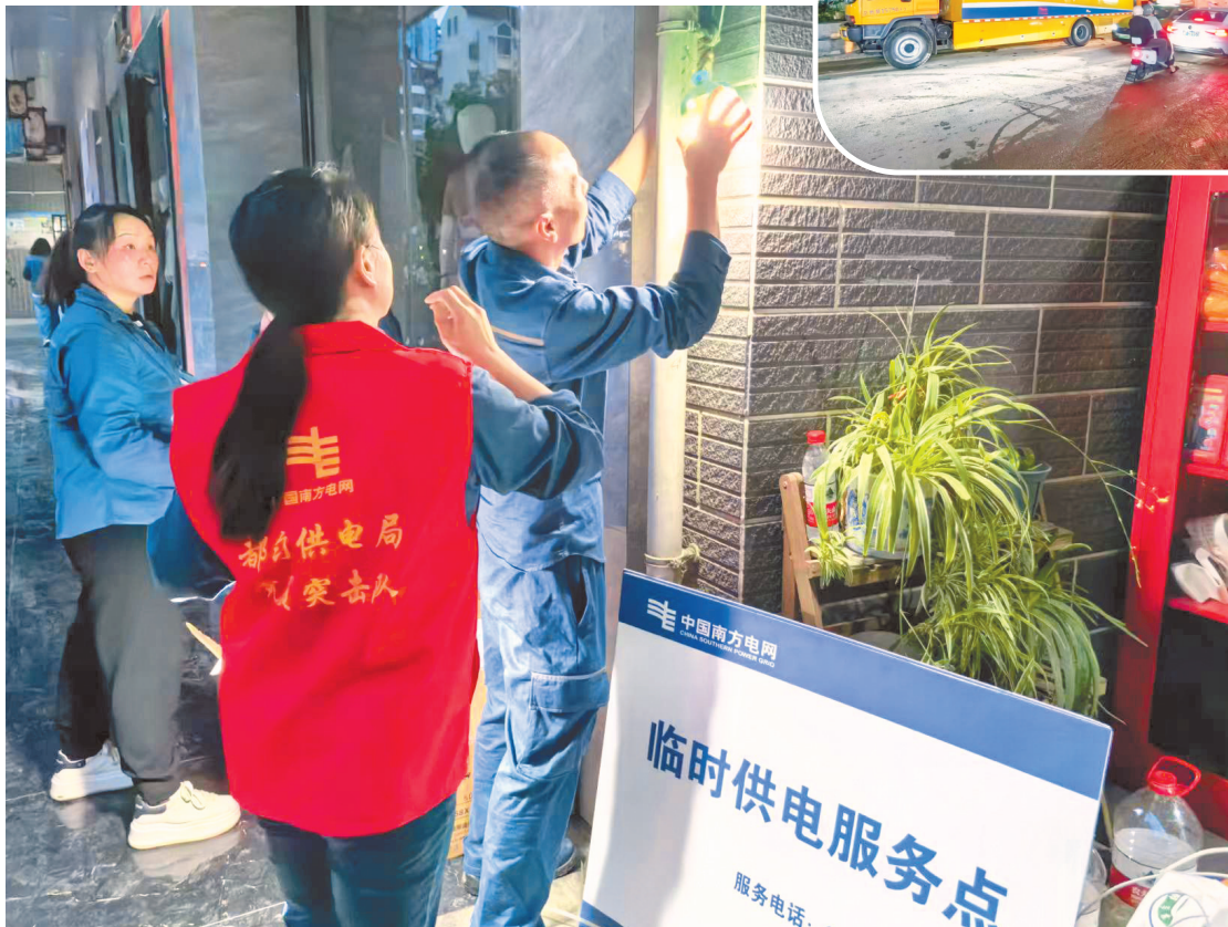
灾情发生后，在黔南州都匀市江城小区，南方电网贵州都匀供电局党员突击队采用3台应急发电车接入小区保障居民正常用电。
