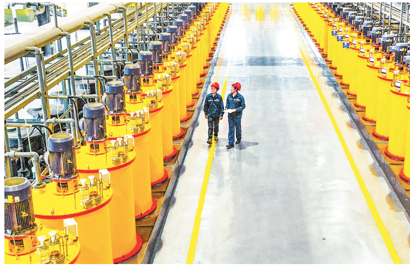
中伟股份铜仁产业基地，一排排巨大的反应釜有序运转。在这里，压力、温度、进料浓度等核心参数被精确调控，最终生成高品质的三元前驱体材料，展现了新能源材料领域先进制造与智能控制的硬核实力。 贵州日报天眼新闻记者 杨涛 摄
